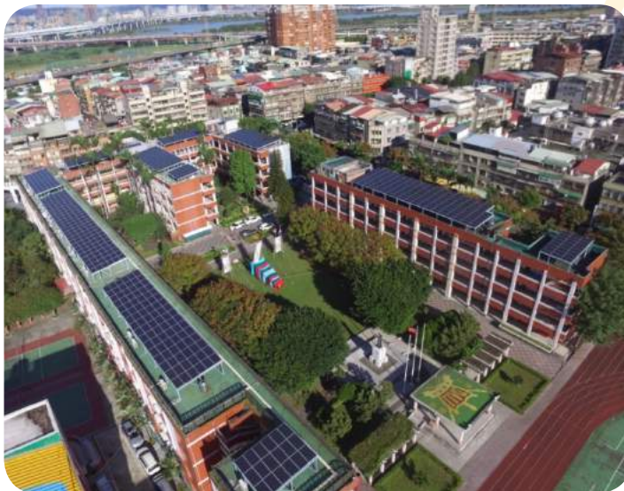
▲ 學校屋頂設置太陽能光電系統
